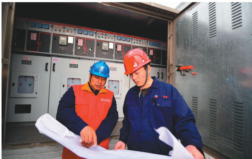
国网沈阳供电公司技术人员上门为供暖企业优化自备用电系统运行方案。陈龙 摄
