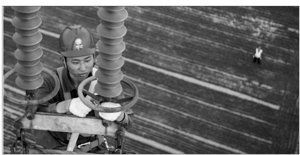
工作人员检查供电设施, 确保线路安全可靠(资料图)。
