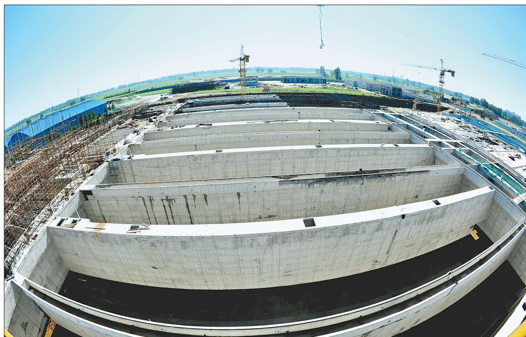
7月10日,高阳县污水处理厂三期工程正在建设中。高阳县紧邻华北明珠白洋淀,为彻底解决纺织印染企业水污染问题,该县今年投资3.2亿元建设污水处理厂三期工程,建成后污水处理厂日污水处理能力将达到26万吨。 记者 杜柏桦 通讯员 沈齐振
