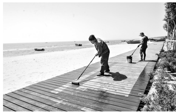
暑期将至,海港区对沙滩浴场的设施 and 环境卫生进行集中整治,为即将到来的旅游高峰做准备。这是近日海港区工作人员在金梦海湾对木栈道进行维护。 记者 赵杰摄
