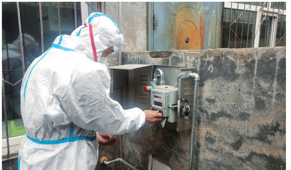
近日,呼和浩特市中燃公司客服二部赛罕金桥所工作人员正在维修壁挂炉。疫情防控期间,为保障辖区内村民的正常生活取暖,呼和浩特市中燃公司客服二部赛罕金桥所在使用气煤的村庄成立送气保障突击队,队员们变身“大白”,为村民气代煤设备进行调试维修,保证村民家中正常供暖。
