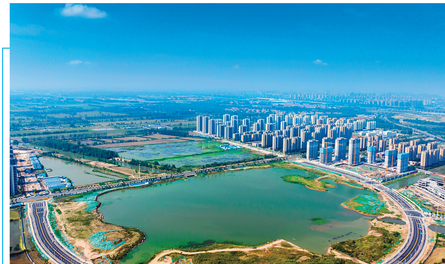
24日,徐州经济技术开发区高铁生态商务区环湖路建设已经完成主体结构,环湖路的建成,将形成“一横、三纵、多点”的空间结构,打造淮海经济区一流的现代城市新区。据介绍,环湖路为规划区内次干路,道路全长1.5289公里,设计时速40公里。 高刚 摄 (视觉江苏网供图)
