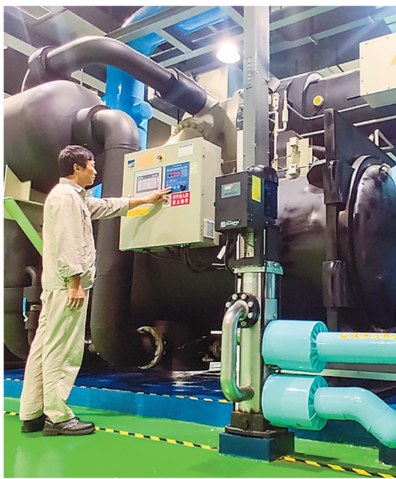
工作人员正在查看江水热源泵主机的运转情况。本报记者 张筠 摄
