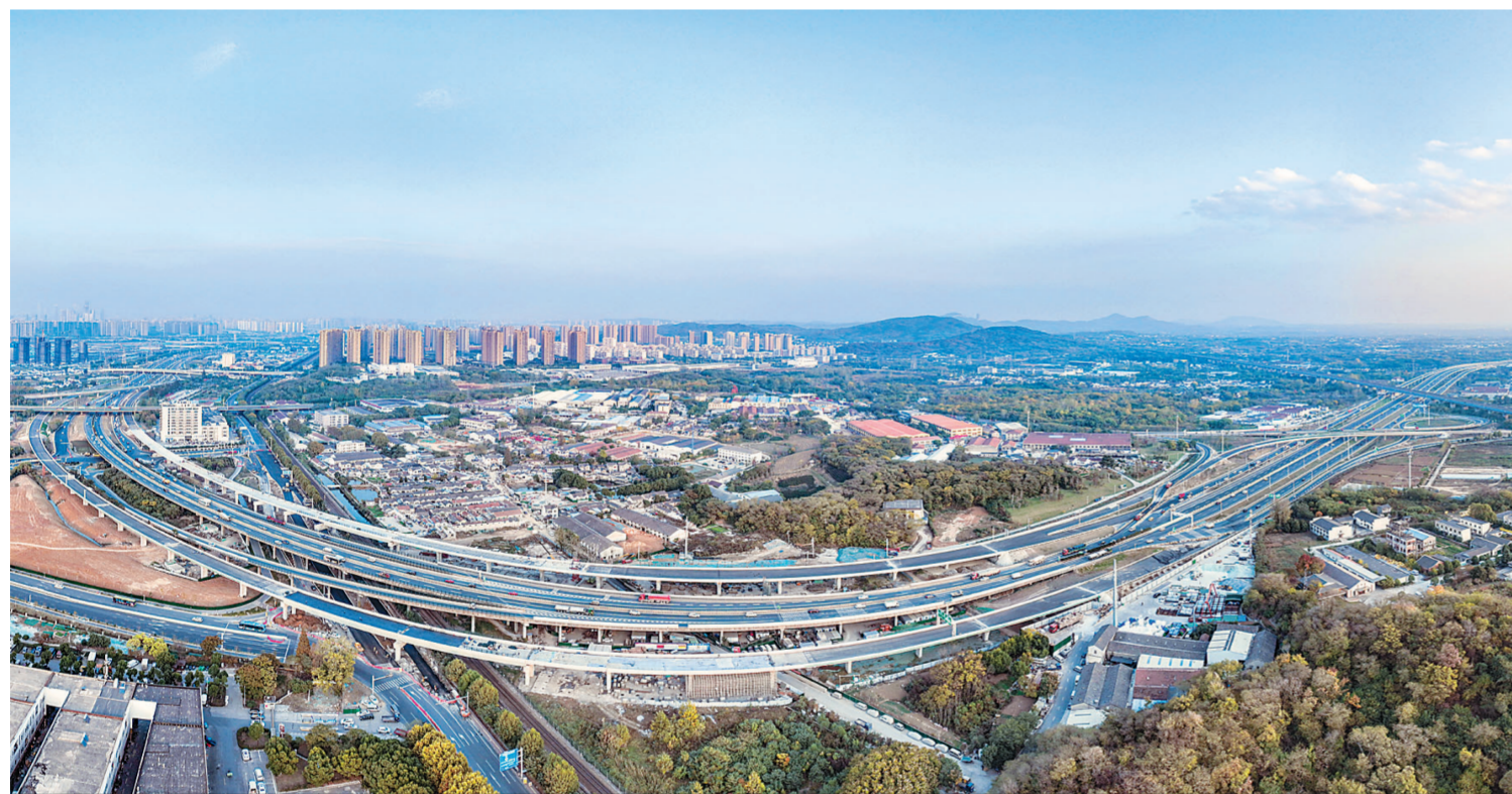
11月9日，航拍宁马高速公路扩建工程。目前，扩建后的公路路基涵洞工程全部完工，正在进行路面及立交、绿化、机电等附属工程施工，并为项目竣工验收做准备。据悉，宁马高速公路扩建工程起自刘村互通，向西南沿既有老路扩建，止于铜井镇(苏皖省界)，路线全长约26公里。 本报记者 邵丹 摄
