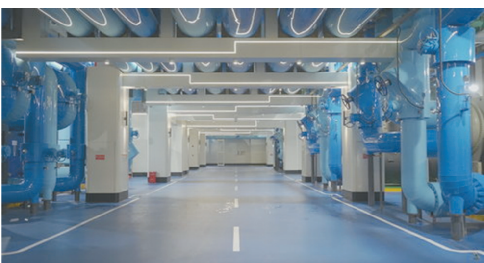
“构建区域能源 助力双碳行动”图片反映了常州高铁新城智慧综合能源站实景，普及可再生能源知识。
