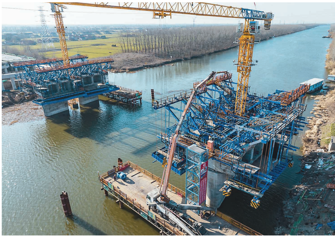
昨日，盐城市二〇四国道盐阜快速通道黄沙港特大桥建设工地上，工人放弃元旦假日休息，坚守岗位忙施工，确保项目在今年如期建成通车。 顾枫摄（视觉江苏供图）
