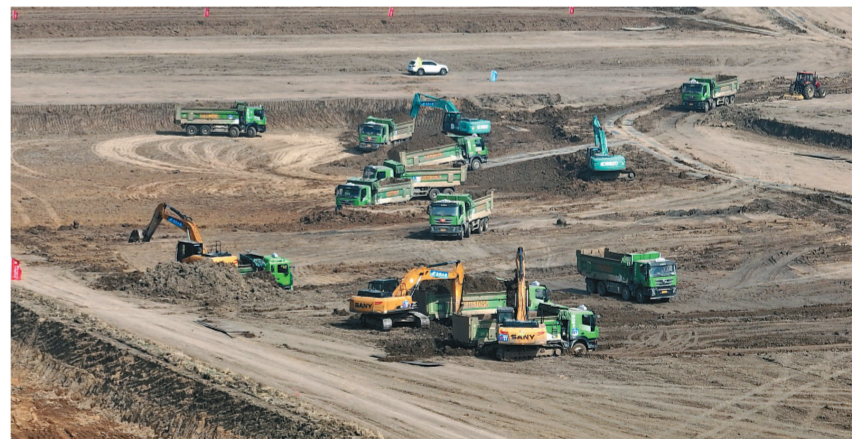
9日,在淮入海水道二期工程淮安段施工现场,工人们加快开展河道全线扩挖以及围堰填筑等工作,抢抓汛期来临前的“窗口期”。 陈凯 摄(视觉江苏网供图)
