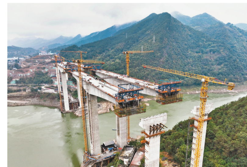
12月1日,北碚区渝武高速公路复线观音峡嘉陵江特大桥施工现场,施工人员在进行桥面浇筑施工作业。
