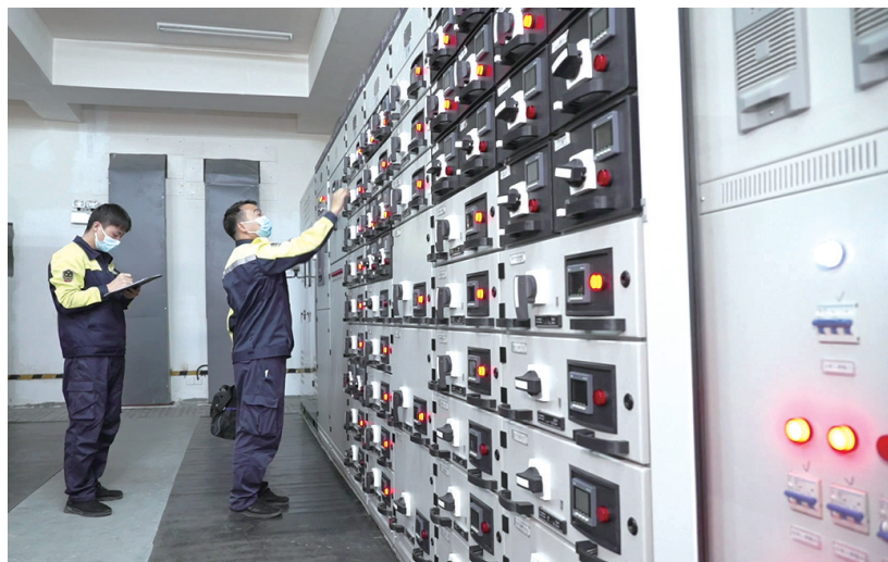
机电专家在配电机房巡检
