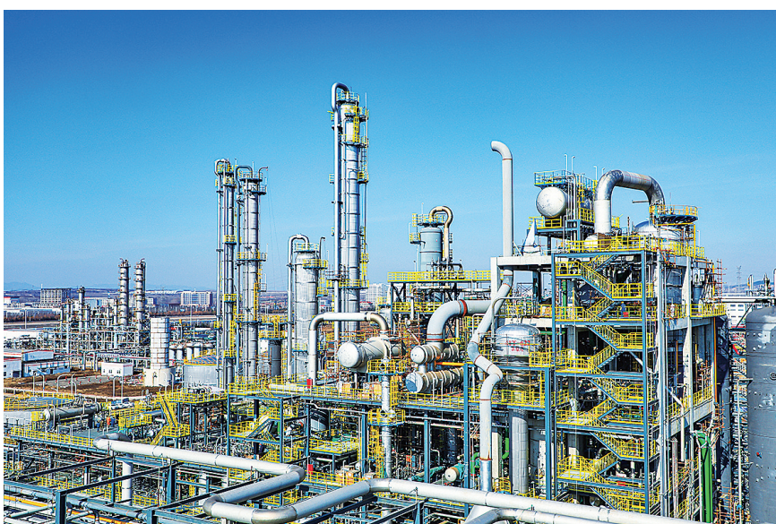
24万吨/年高端聚碳酸酯用双酚A项目主装置管道设备安装已基本完成。
