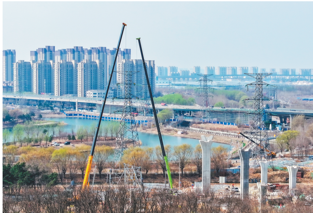
配合沈阳元江街快速路项目建设的电力线路迁改工程正在组建新塔。
