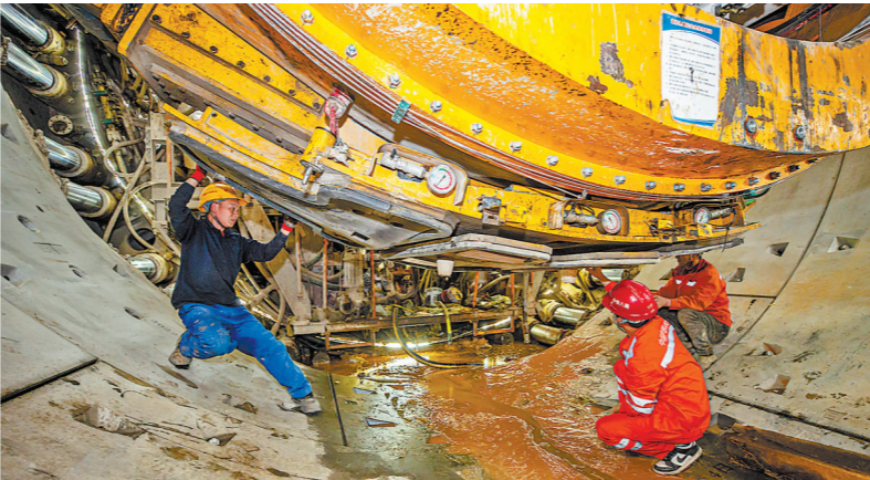
1月29日,福州滨海快线施工现场一片繁忙。滨海快线起于福州火车站,终于文岭站,途经福州老城区、滨海新城、长乐国际机场。目前,滨海快线全线车站已动工,10个车站主体结构已封顶,19台盾构机正在掘进。图为中铁八局工人检修维护盾构机。 本报记者 林熙 摄
