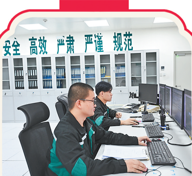
▲春节期间,丰宁抽水蓄能电站工作人员在中控室值守。
