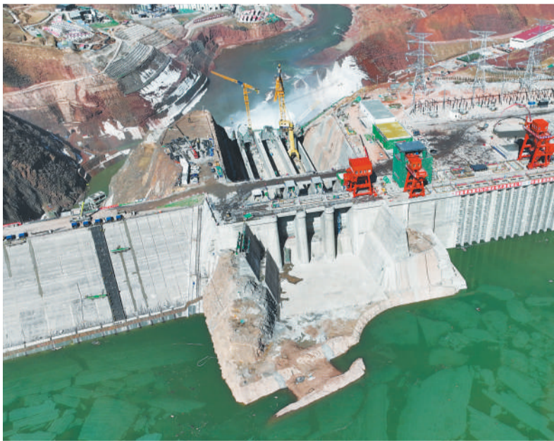
这是四月一日拍摄的玛尔挡水电站。当日，玛尔挡水电站首台五号机组正式并网发电。该水电站位于青海省海南藏族自治州同德县与果洛州玛沁县交界处的黄河干流上，是黄河流域在建海拔最高、装机最大的水电工程。
