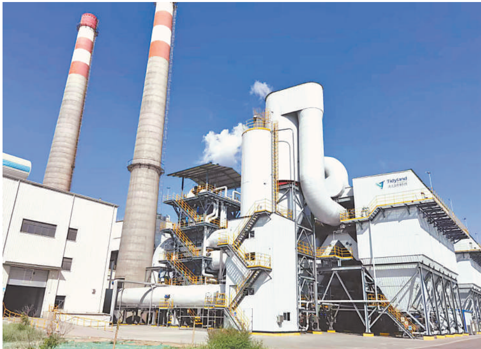
宁夏金晶科技有限公司一体化环保系统实现了行业内烟气治理达到超低排放的目标。
